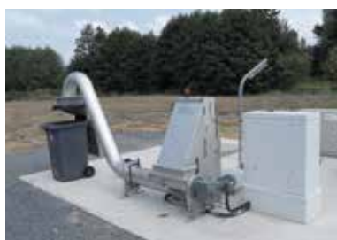
Station de pompage équipée d'un dégrilleur automatique
