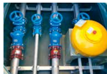
Ballon anti-bélier dans le regard pour protéger les systèmes de pompage et le réseau de refoulement
