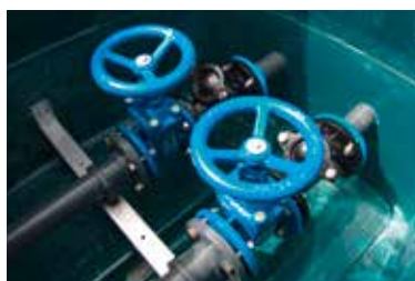
Regard avec robinetterie revêtue époxy
