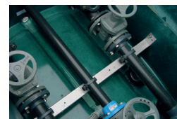
Intérieur du regard avec clapets et vannes
