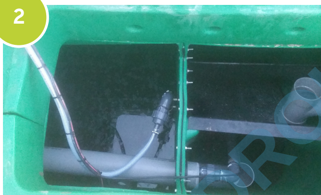
Vue d'ensemble de l'installation terminée avec liaison compresseur / diffuseur d'air et connexion pompe de recirculation vers le bassin d'aération.
