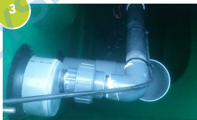
Détail de la connexion de la pompe de recirculation vers le bassin d'aération.
