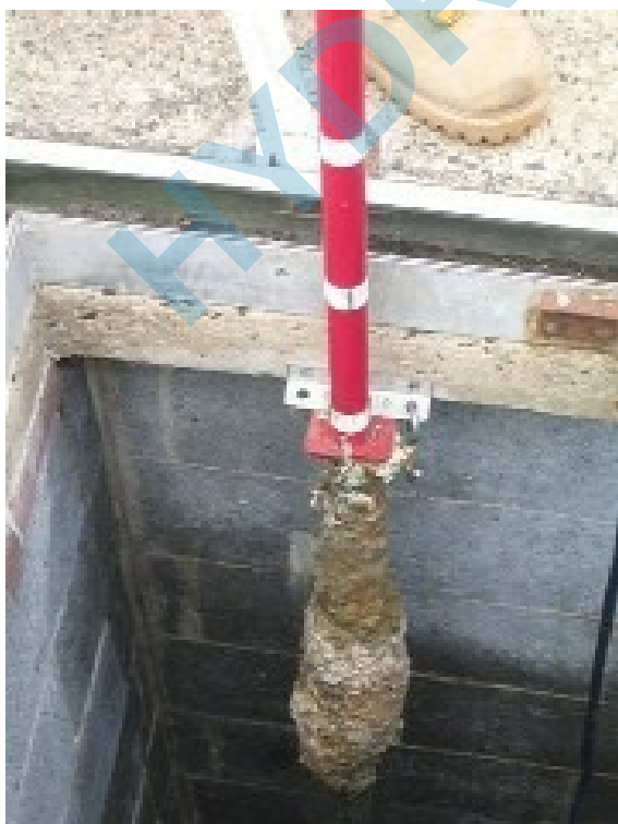
Application Fosse à graisse L'encrassement n'empêche pas le fonctionnement de la sonde
